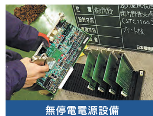
無停電電源設備
