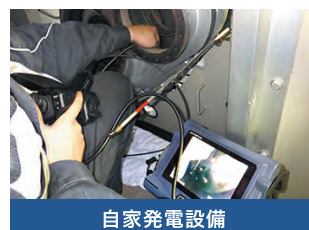
自家発電設備
